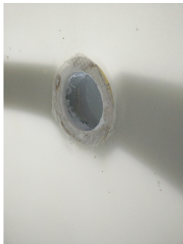
(c) Eines der beiden mit Plastikkappen abgeklebten Löcher in der Mantelfläche
